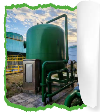
冷卻循環水旁濾系統
