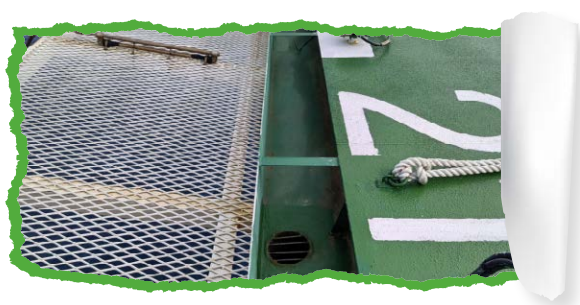
平台直升機甲板收集雨水槽
